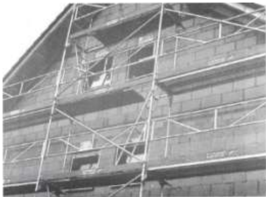
Andamio metálico exterior
