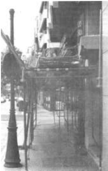
Andamio de garantía en vía pública. Foto JCGL
