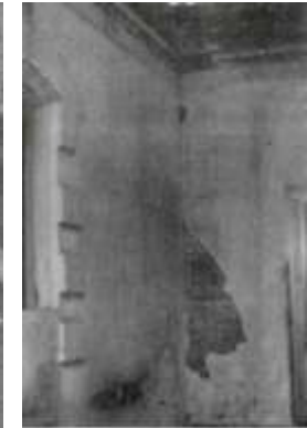
Deterioro que origina cierre interior. Foto JCGL
