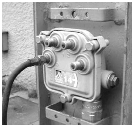
Figura 67. Taps de 4 vías conectado
